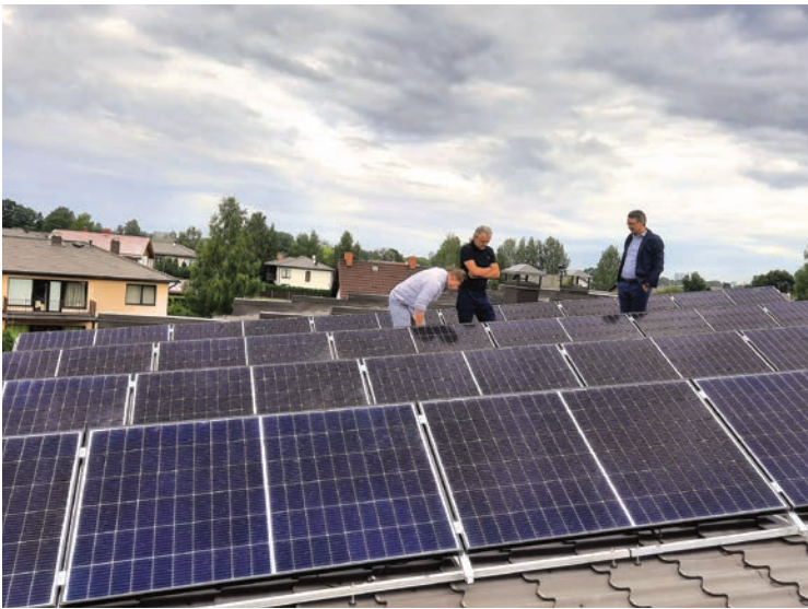
Uz rindu mājas Lielajā ielā 160 jumta izvietoti saules paneli, kas ļaus ievērojami samazināt elektrības rēķinus
